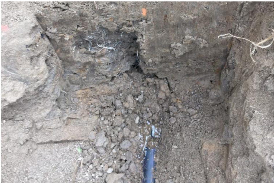
Figuur 19 Een duidelijke scheur zichtbaar boven een diepdruppelslang.
